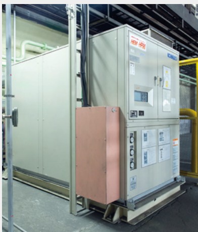
熱回収ヒートポンプ
