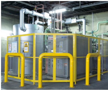
熱回収ヒートポンプ
